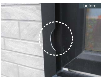
外部サッシ割れ補修2
