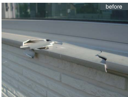
外部サッシ割れ補修3
