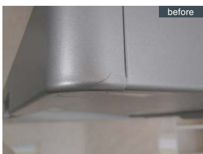
レンジフード色剥がれ補修
